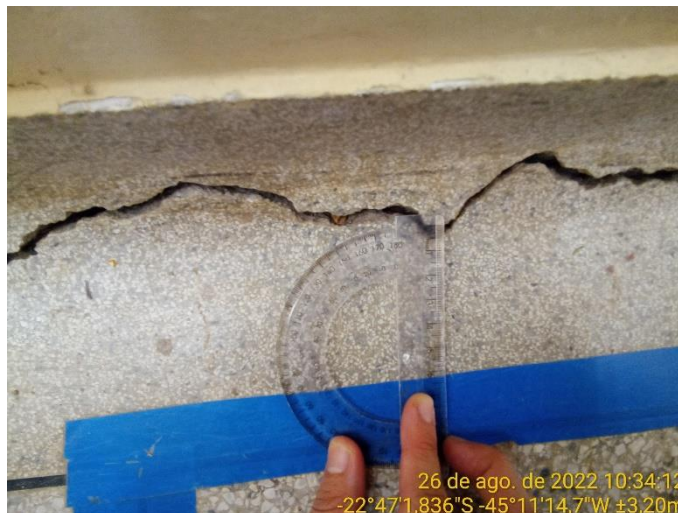
8.4 Detalhe piso sala de aula com rachadura
