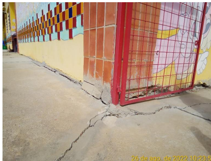
1.2 Detalhe rachadura na calçada que contorna a escola
