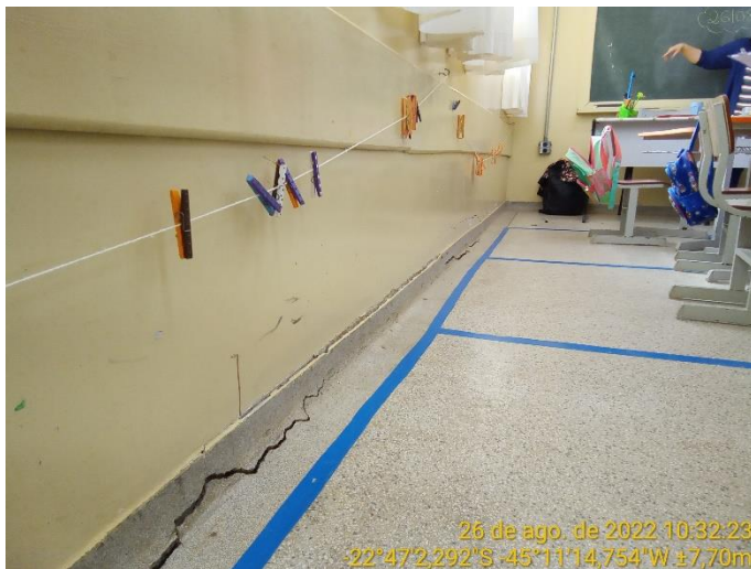
6.1 Piso sala de aula com rachadura
