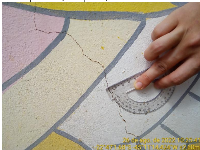
2.1 Fissura na parede externa da escola
