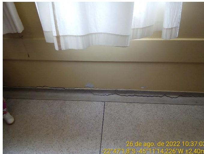
9.4 Piso sala de aula com rachadura
