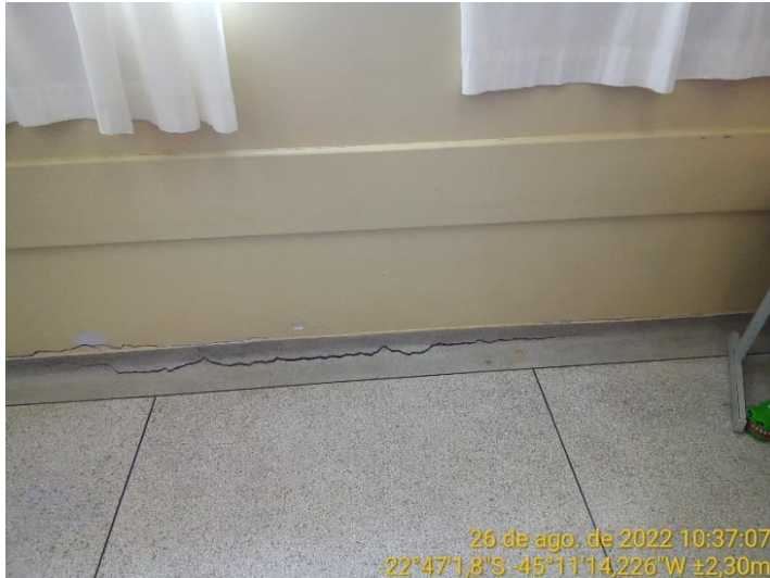
10.1 Piso sala de aula com rachadura
