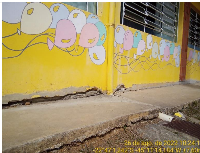
2.2 Vão entre a calçada e a parede da escola
