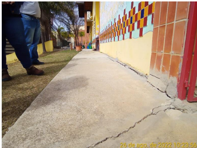
1.1 Rachadura na calçada que contorna a escola
