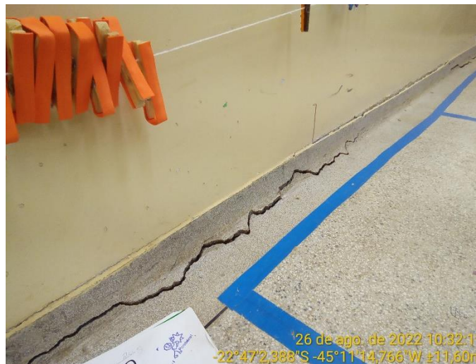
6.2 Detalhe piso sala de aula com rachadura
