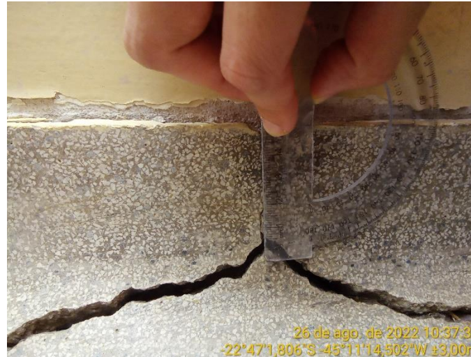
10.2 Detalhe piso sala de aula com rachadura (+ 5 mm)
