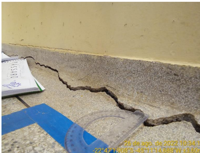
8.2 Detalhe piso sala de aula com rachadura
