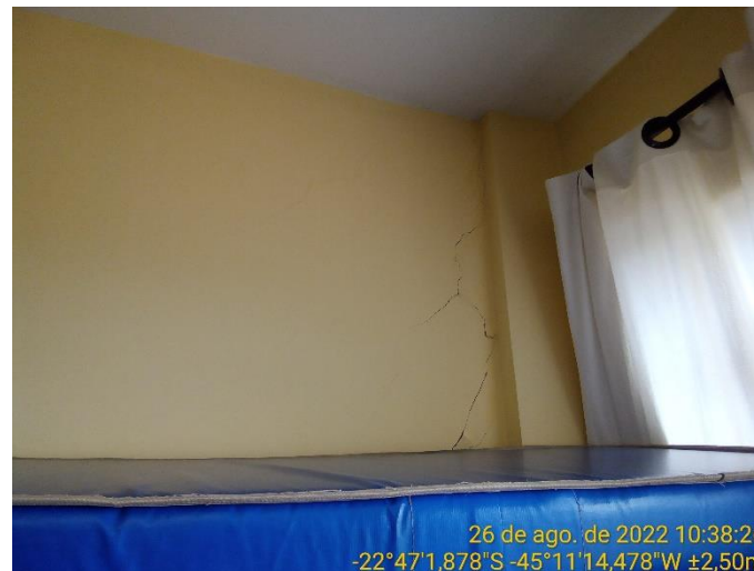
10.4 Rachadura à 45° na parede de sala de aula
