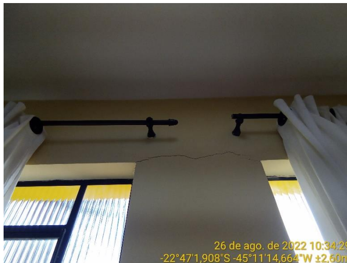
7.4 Trinca nas quinas das janelas (visão interna)
