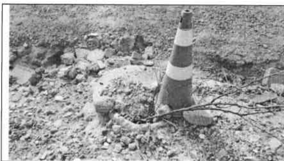
Foto 5: Tampão quebrado do PV
