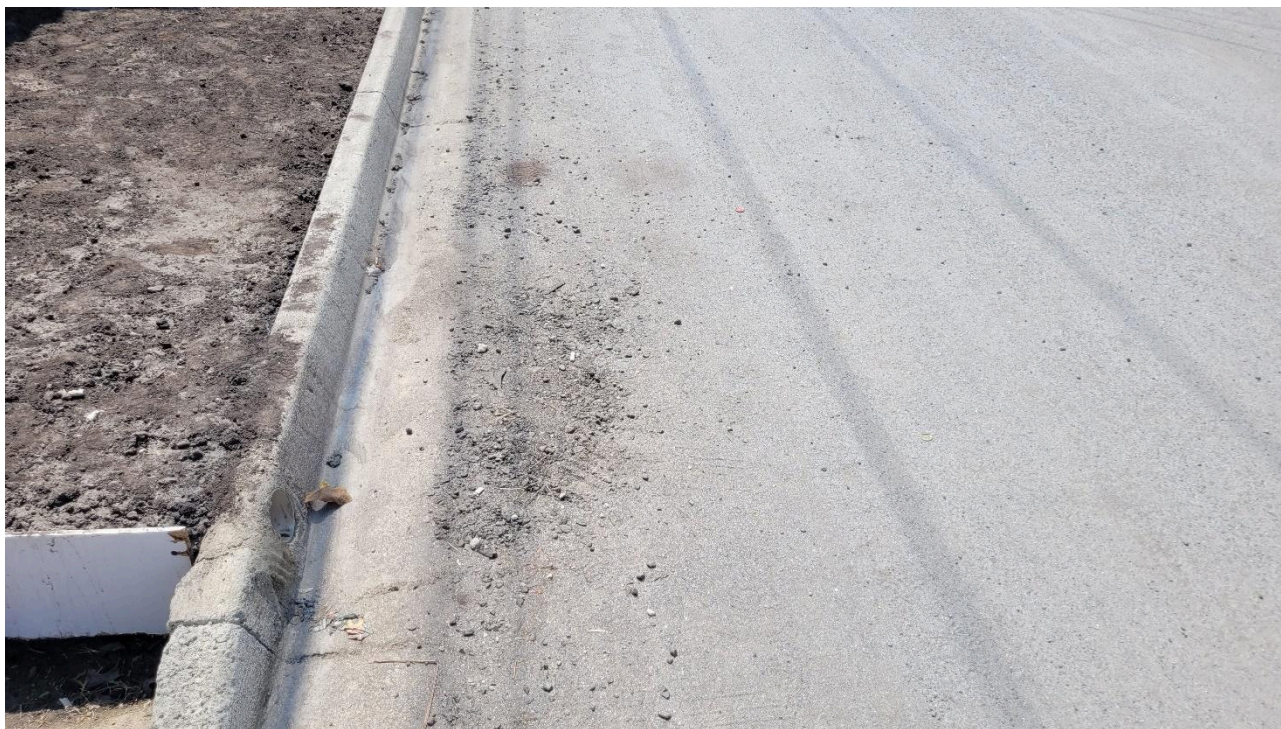
Imagem 23 – Vistoria 13/09/2024 – Bairro Vila Bela.
