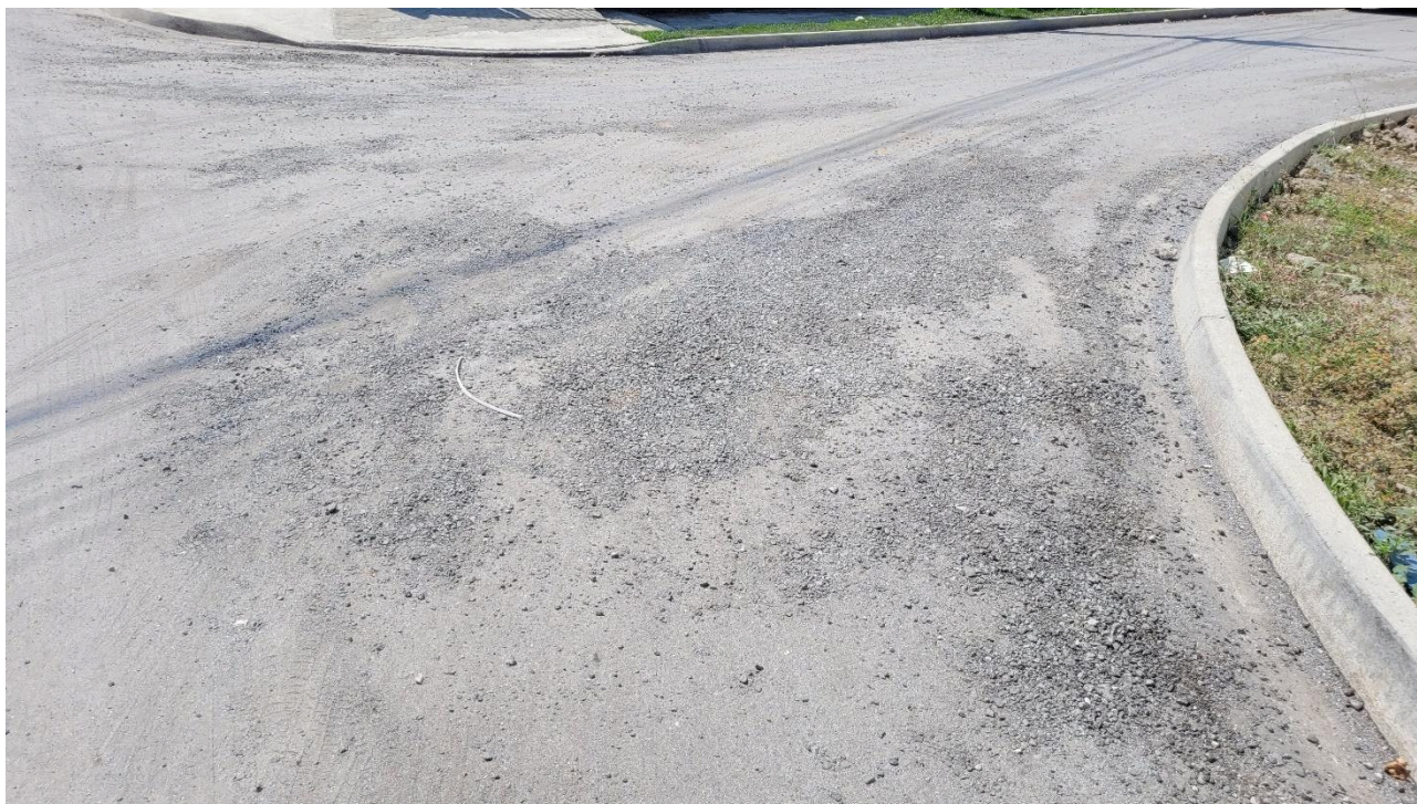
Imagem 14 – Vistoria 13/09/2024 – Bairro Vila Bela.
