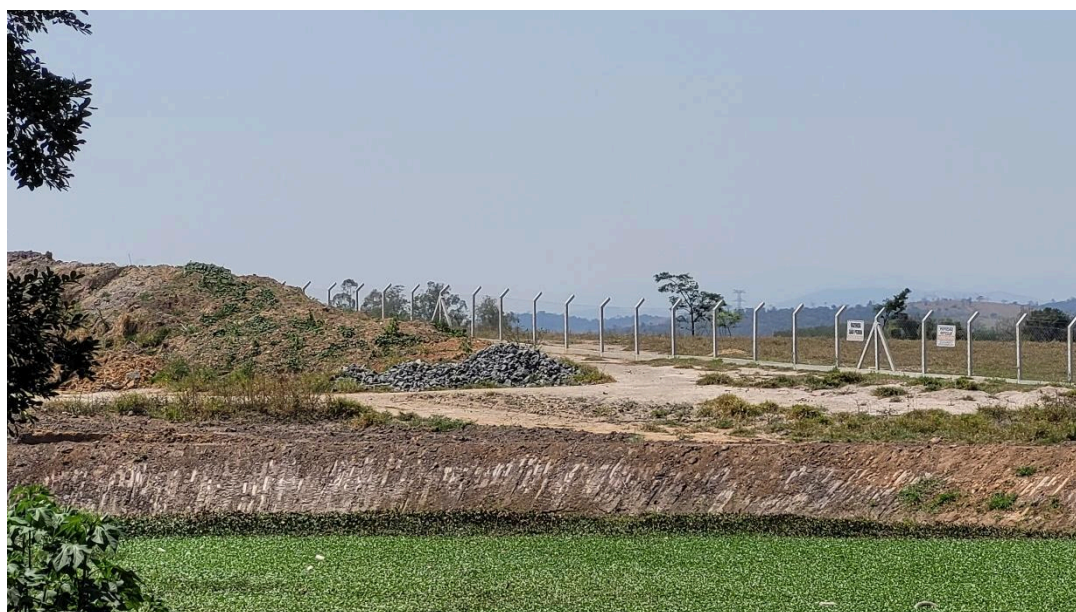
● Imagem 02 – Vistoria 12/09/2024 – Quantidade de pedras dispostas na obra (aproximadamente a capacidade máxima de um caminhão basculante).
