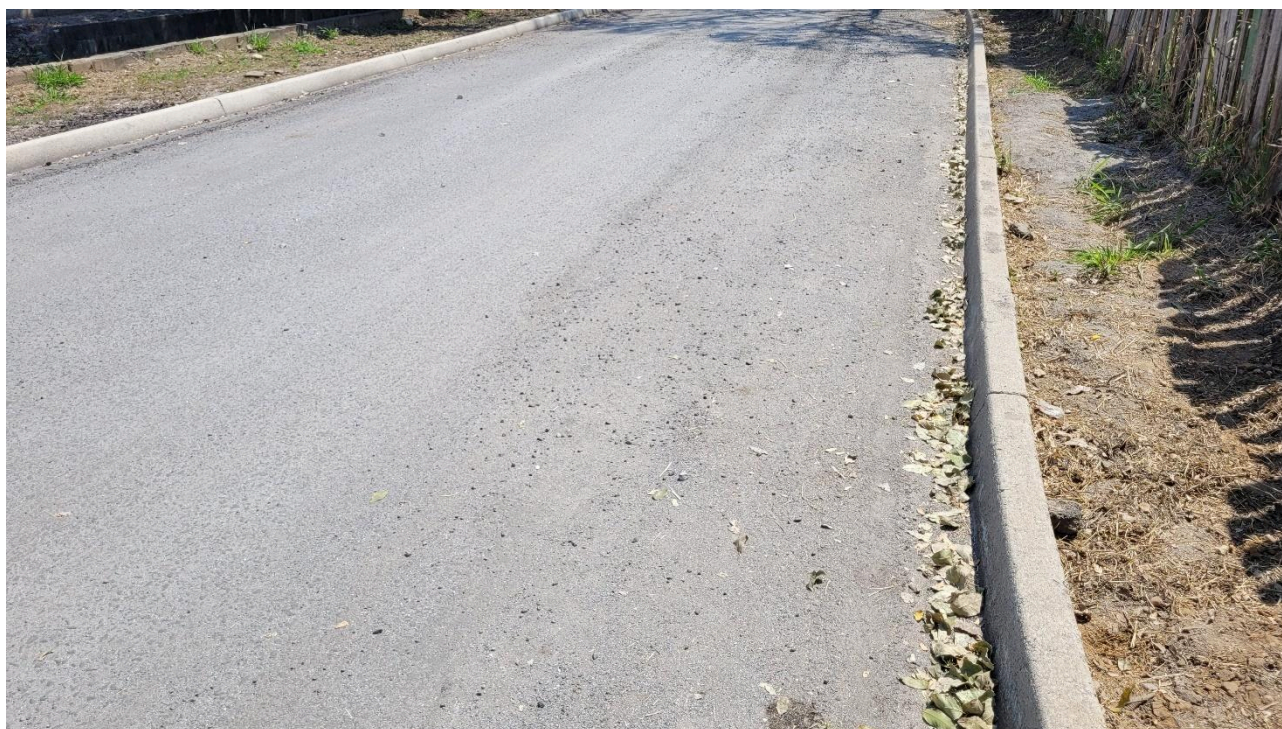
Imagem 16 – Vistoria 13/09/2024 – Bairro Vila Bela.
