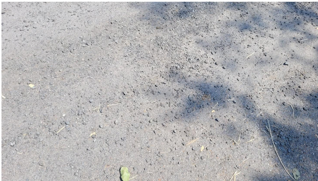
Imagem 17 – Vistoria 13/09/2024 – Bairro Vila Bela.
