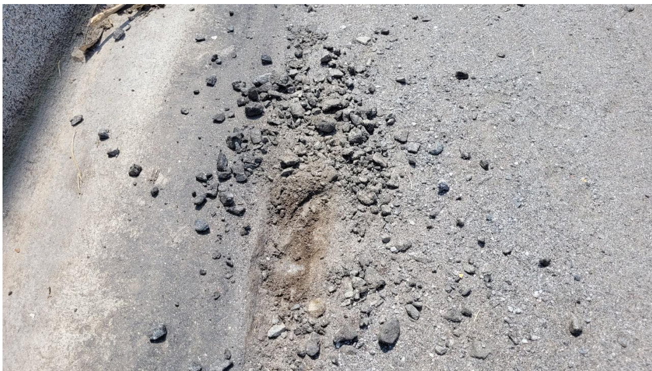
Imagem 22 – Vistoria 13/09/2024 – Bairro Vila Bela.
