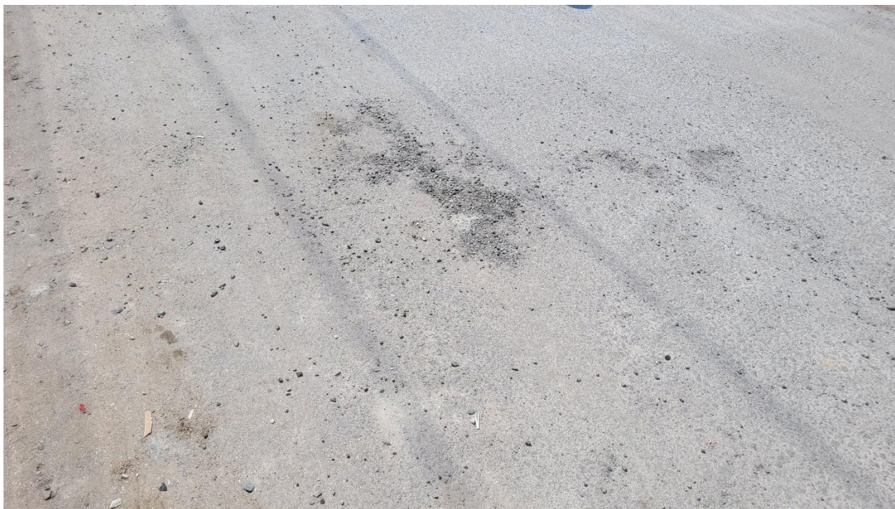
Imagem 13 – Vistoria 13/09/2024 – Bairro Vila Bela.
