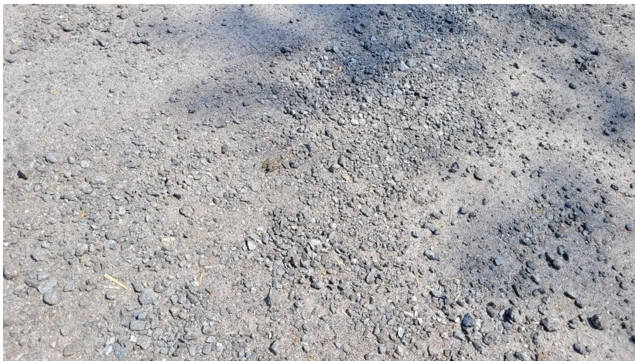
Imagem 18 – Vistoria 13/09/2024 – Bairro Vila Bela.
