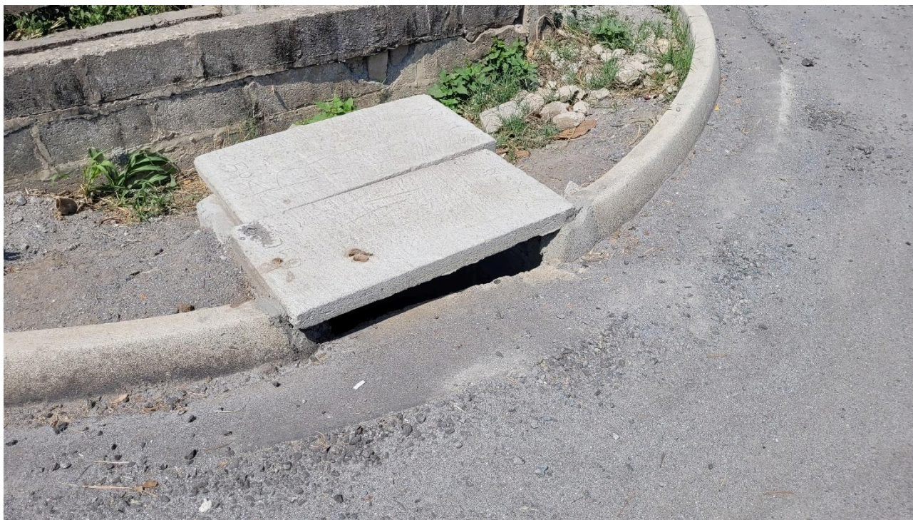
Imagem 21 – Vistoria 13/09/2024 – Bairro Vila Bela.
