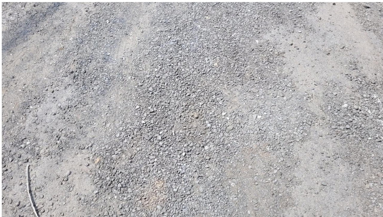
Imagem 15 – Vistoria 13/09/2024 – Bairro Vila Bela.
