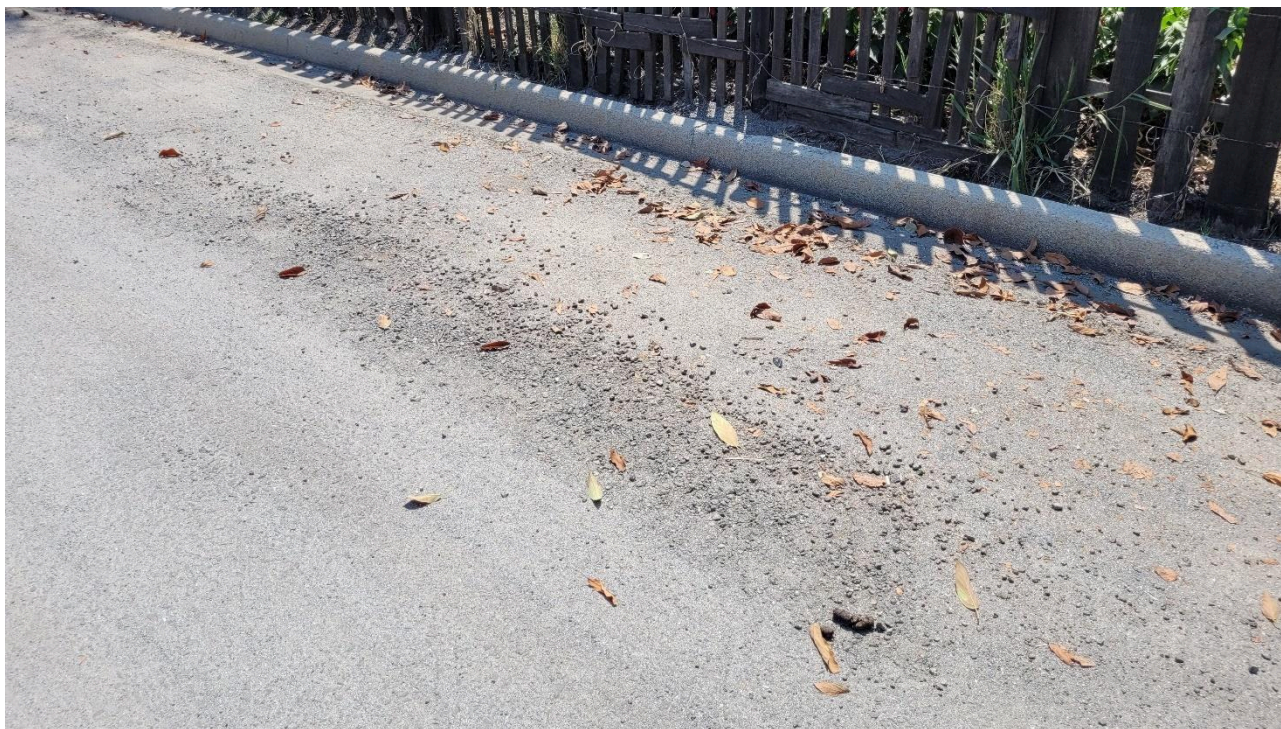
Imagem 19 – Vistoria 13/09/2024 – Bairro Vila Bela.
